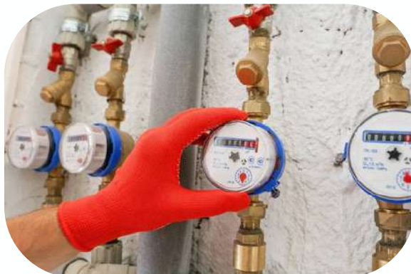
Lettura gruppi di misura energia elettrica, gas, acqua
